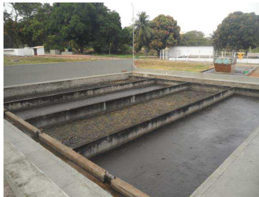
Figura 2. Unidade do leito de secagem do lodo.
