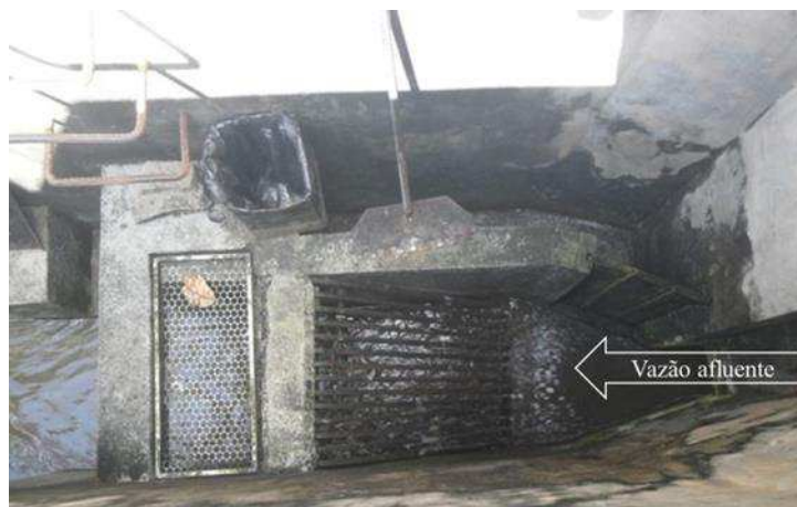
Figura 2. Unidade de remoção de sólidos grosseiros: gradeamento, bandeja, rastelo e saco plástico.
