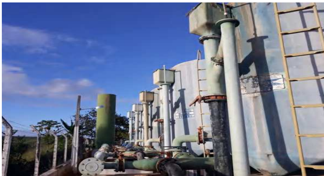
Figura 5 - Ilustra tubulações de entrada de água ETA e saída (Lavagens dos filtros)
