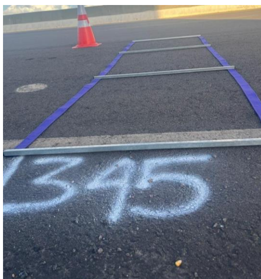
Figura 23 - Medição da área trincada conforme DNIT 433/2021-PRO
