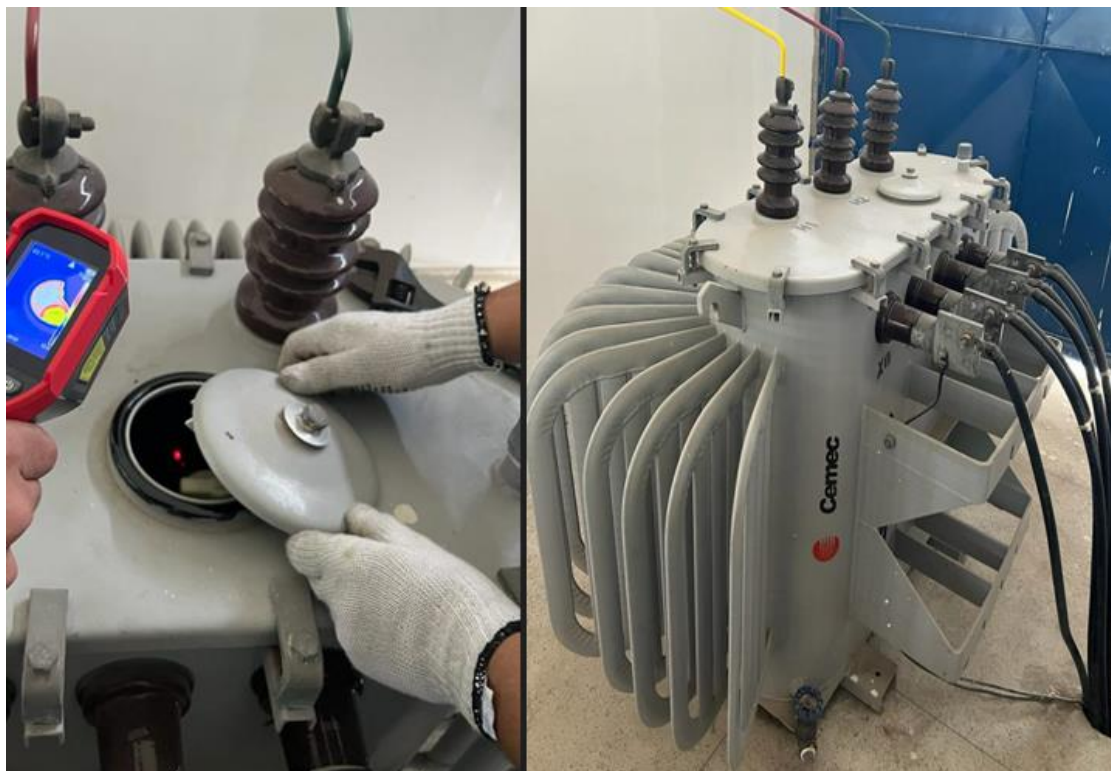
Figura 9 – Inspeção termográfica em transformador de 300kVA.
