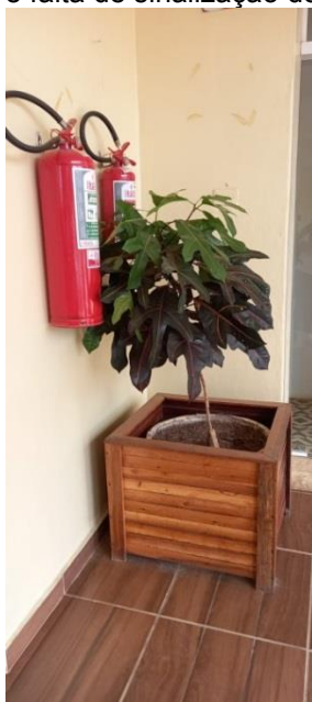
Figura 6 - Obstrução do local e falta de sinalização dos extintores no Bloco D
