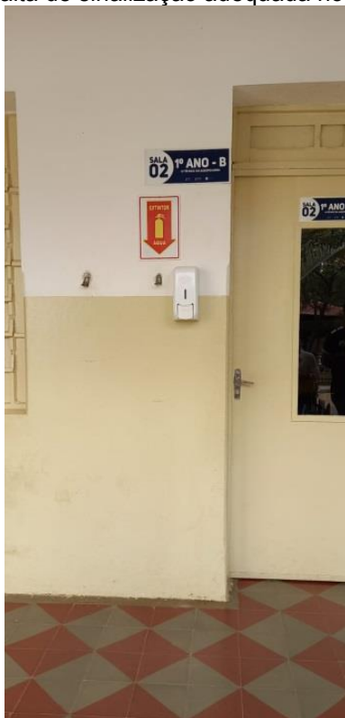
Figura 4 - Falta de sinalização adequada no Bloco G e H
