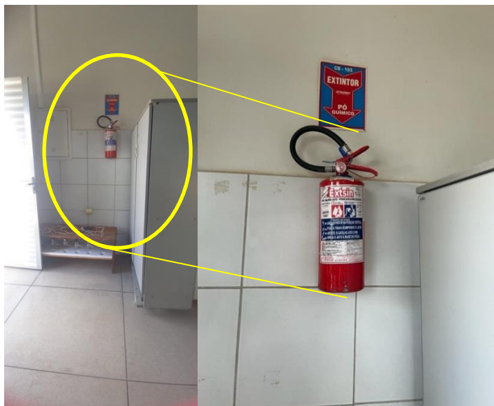
Figura 5 -Extintora sem a sinalização completa no Bloco A
