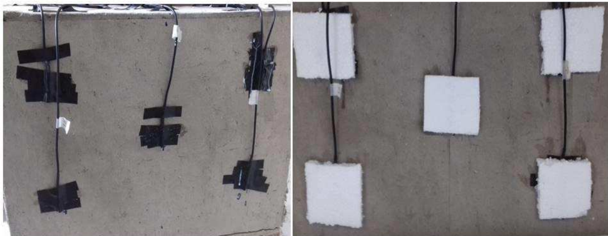
Figura 15- Instalação dos sensores nas minis paredes. Inicialmente coloca-se os sensores com fita isolante e depois passa silicone. No final coloca isopor sobre os sensores.
