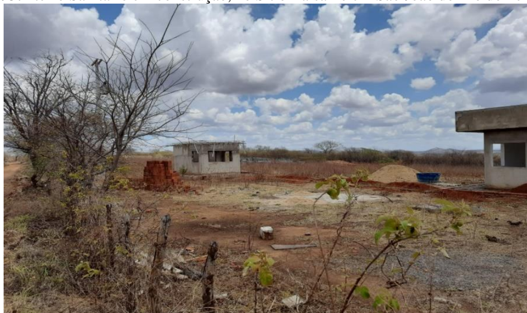
Figura 3: Aterro Sanitário em construção, no Sítio Balsamo em São João do Rio do Peixe - PB.
