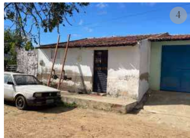
Figura 25 - Calçada Irregular Fonte: SEDU (2023)
