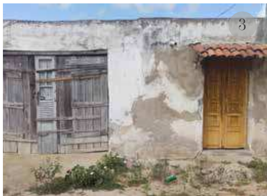
Figura 29 - Casa abandonada Fonte: Maria Eugênia Valença (2023)
