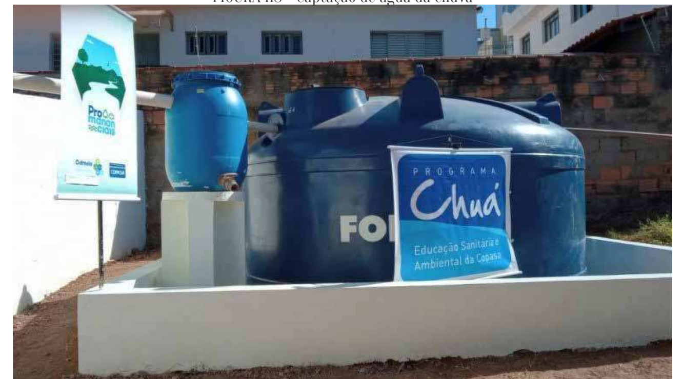
FIGURA II8 - Captação de água da chuva
