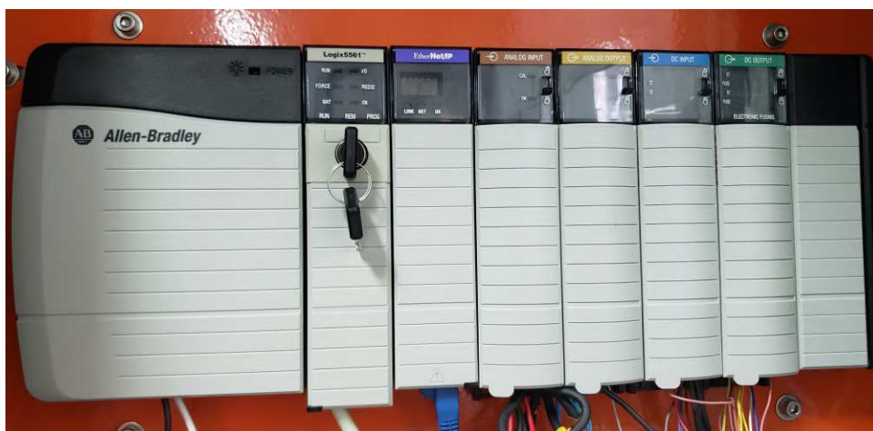
Figura 11 – CLP utilizado na planta
