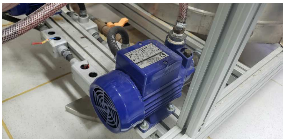
Figura 14 – Motor-bomba usado na planta
