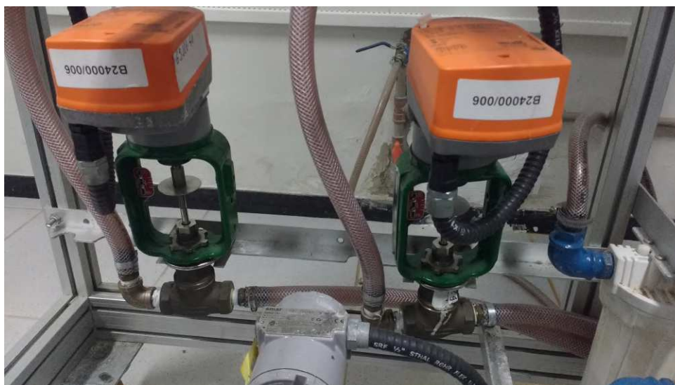
Figura 13 – Válvulas elétricas utilizadas na planta
