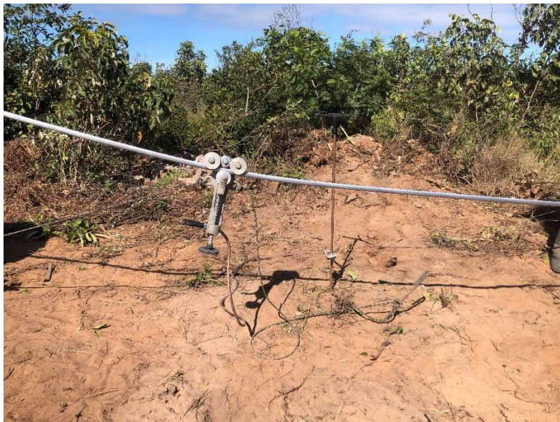
Figura 30 – Aterramento móvel em bobina de cabo condutor.
