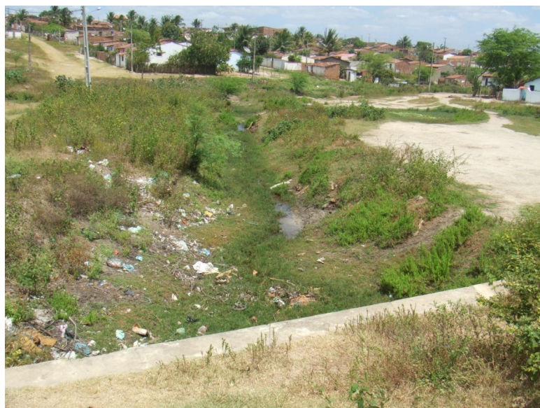
Figura 17. Esgotos a céu aberto e infra-estrutura deteriorada
