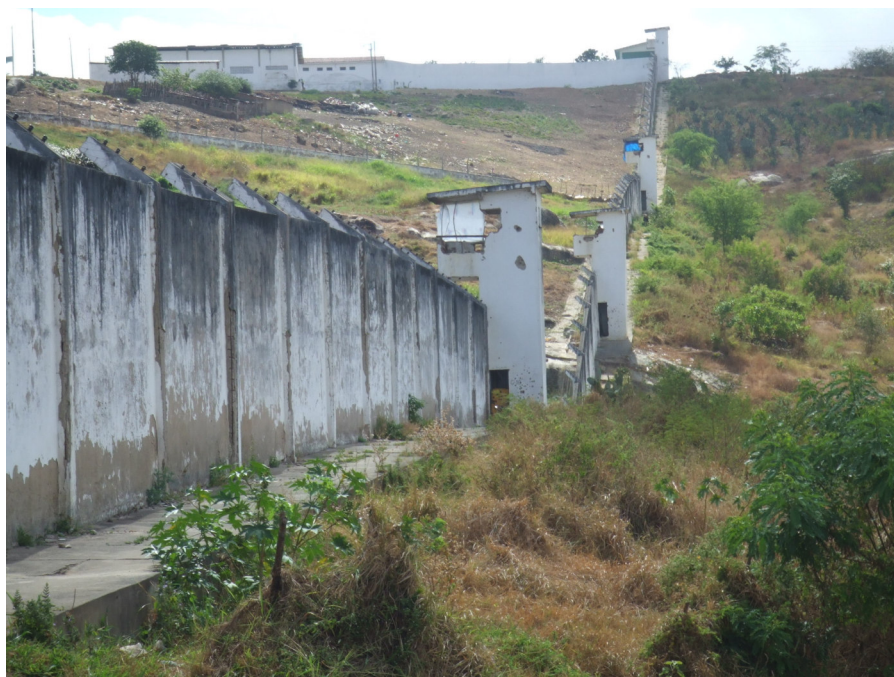
Figura 11. Estado de conservação dos muros do serrotão
