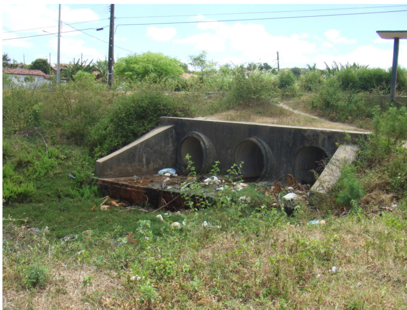
Figura 43. Imagem de esgoto lançado a céu aberto
