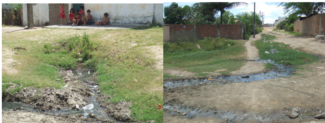
Figura 35. Esgotos correndo a céu aberto, nas ruas do Mutirão
