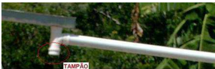
Figura 17. Dispositivo para o desvio manual das águas das primeiras chuvas
