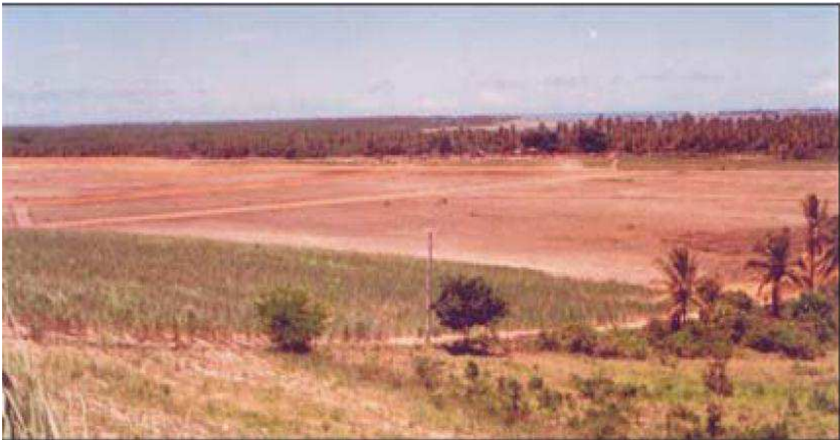
Figura 23: Viveiro de camarão em construção, evidenciando o crescimento da atividade de carcinicultura na região de estudo.
