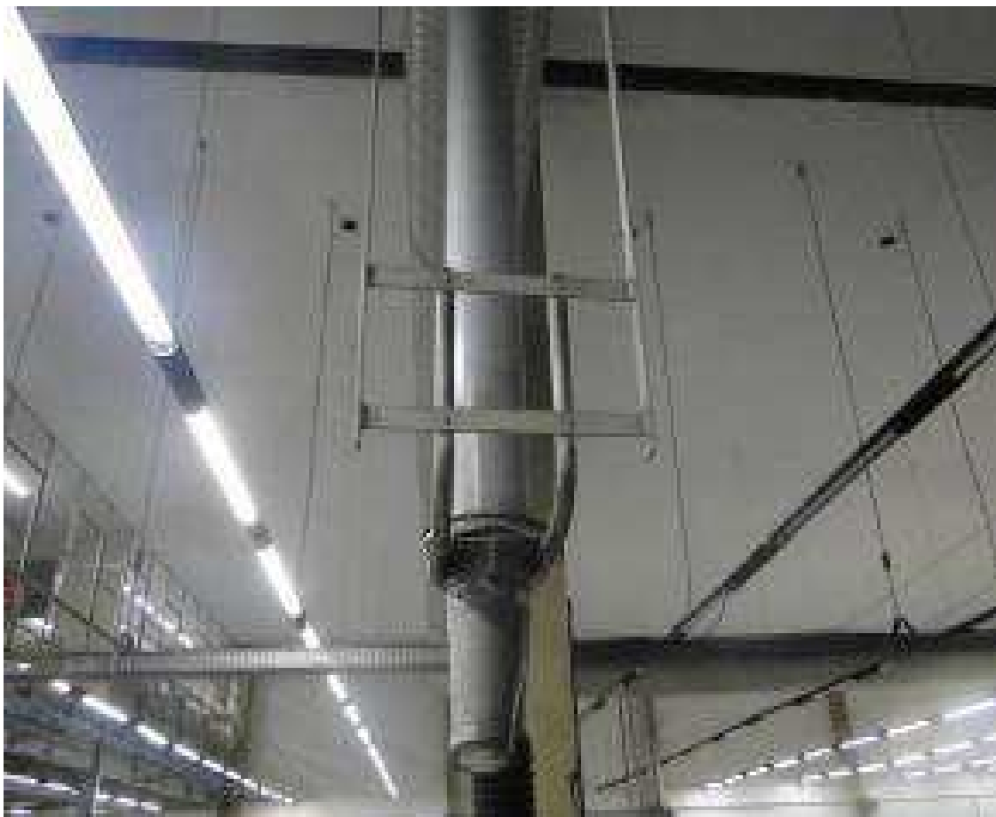
Figura 28. Sistema de exaustão do laboratório automotivo do CTGAS-ER.
