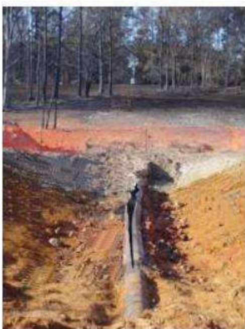
Figura 2.10: Gasoduto subterrâneo rompido em 2007 nos Estados Unidos. Fonte: NDTcabin, 2010.
