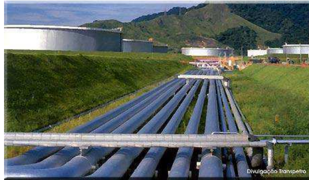
Figura 2.8:Conjunto de oleodutos conectados a TRANSPETRO
