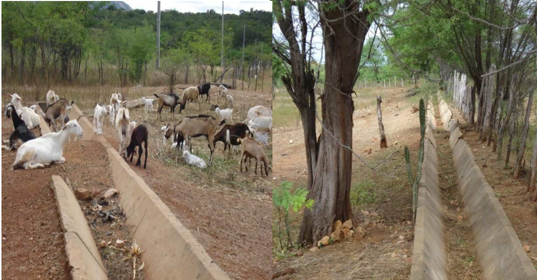
Fotos 60 e 61: canais secundários, aterrados e deteriorados
