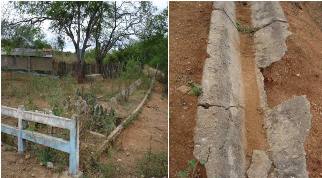
Fotos 62 e 63: Trechos dos canais secundários quebrados
