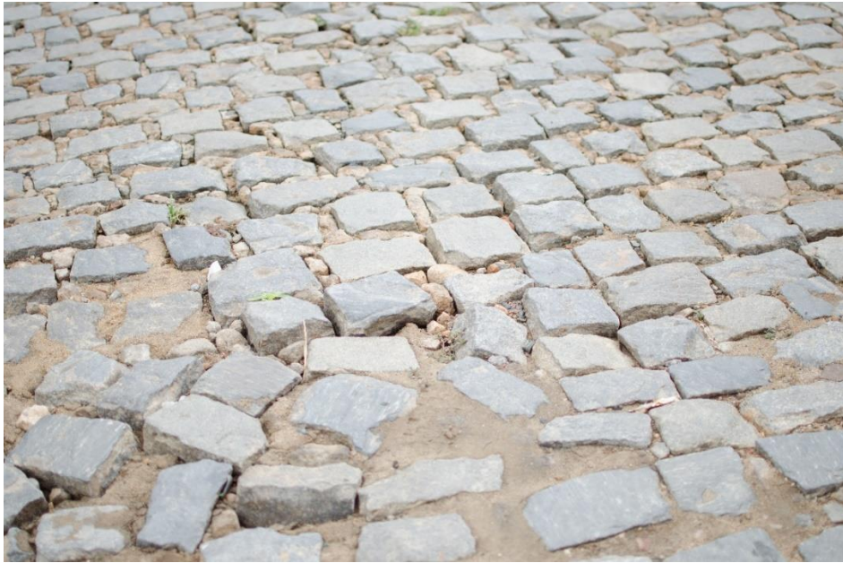
Figura 5 - Calçamento inadequado. Fonte: Autor
