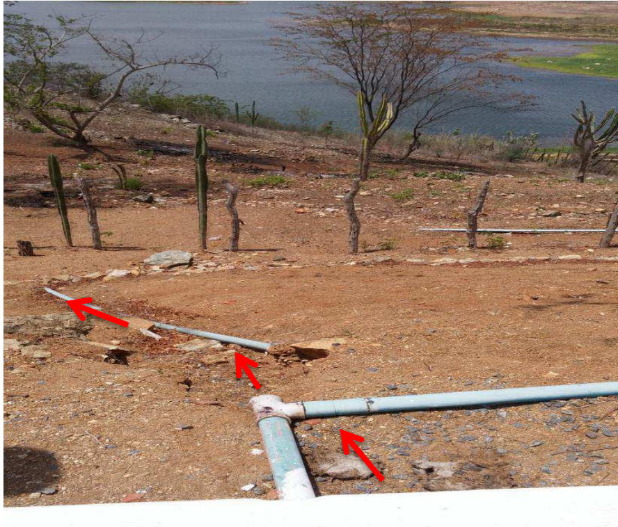
Figura 19 – Tubulação de efluentes direcionada para dentro do reservatório Epitácio Pessoa.
