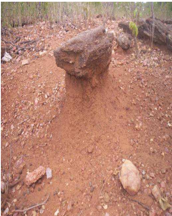
Imagem 7d – Área Degradada Erosão (PA Feijão/Mandacaru)
