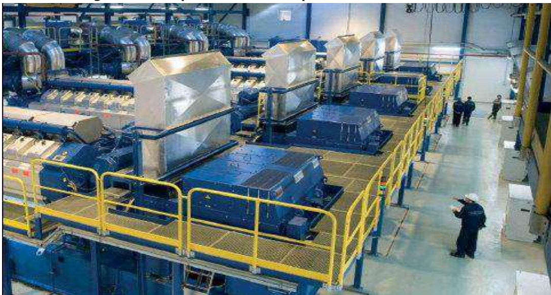
Figura 1. Exemplo de sala de máquinas de uma UTE.
