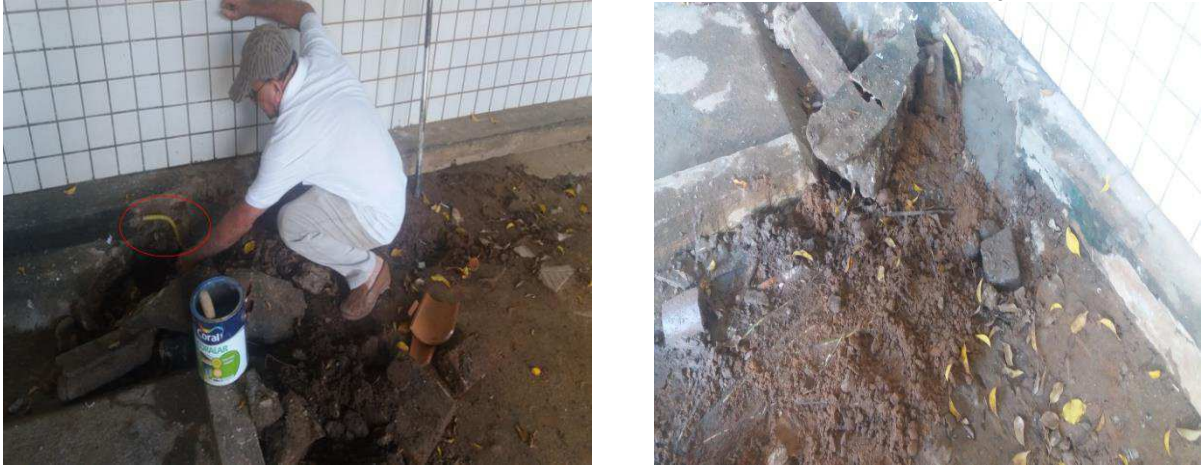
Figura 19 e 20: Concerto do ponto de vazamento encontrado na encanação.*
