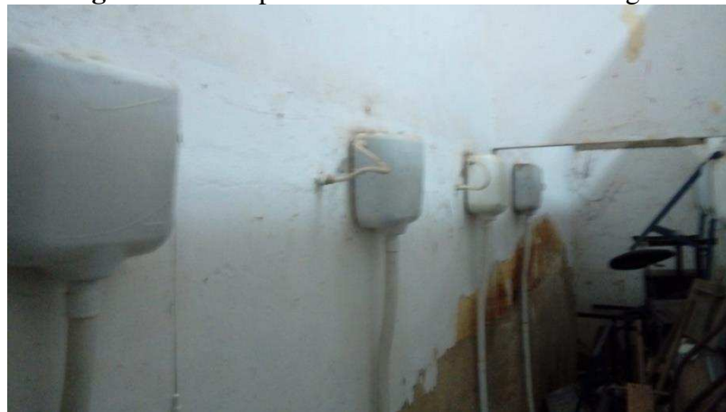
Figura 21: Compartimento das caixas de descarga.*
