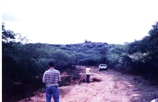
Figura 26 – Processo erosivo em estrada implantada no Município de Sousa, 2003.
