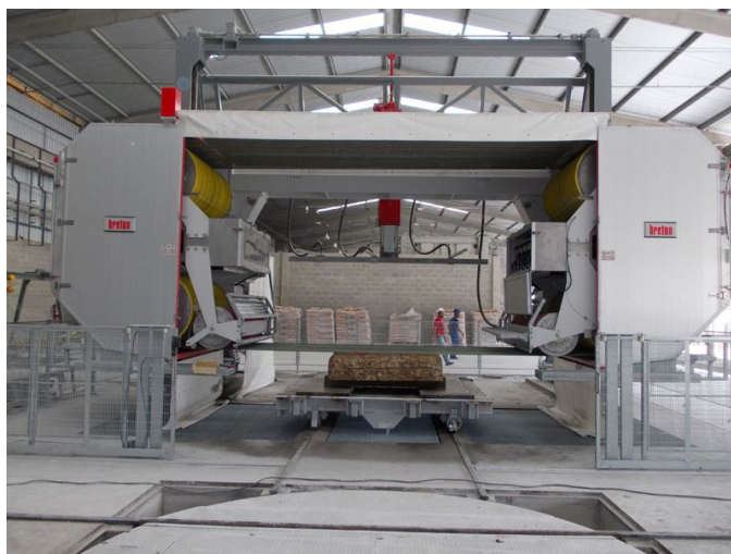
Figura 5 – Tear italiano Multi-fio GOLDBRETON modelo 2000/7 no setor de serragem primária
