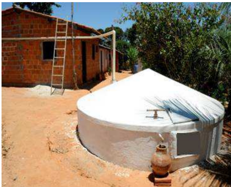
Fotografia 1: Cisterna de placas. Sítio Alagoinha, Pau dos Ferros, 2014.
