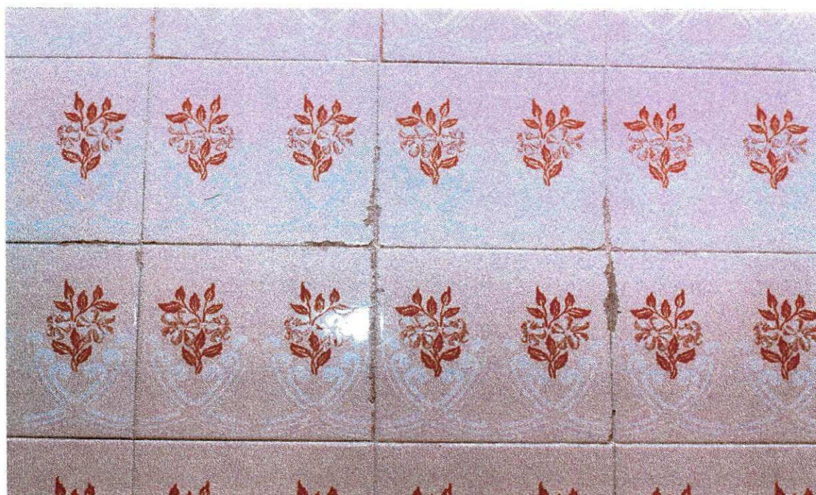
FIGURA 2.06 – Ilustração da desintegração de alvenaria causada pelo confinamento de depósitos de sais devido à aplicação de revestimentos cerâmicos vítreos.
