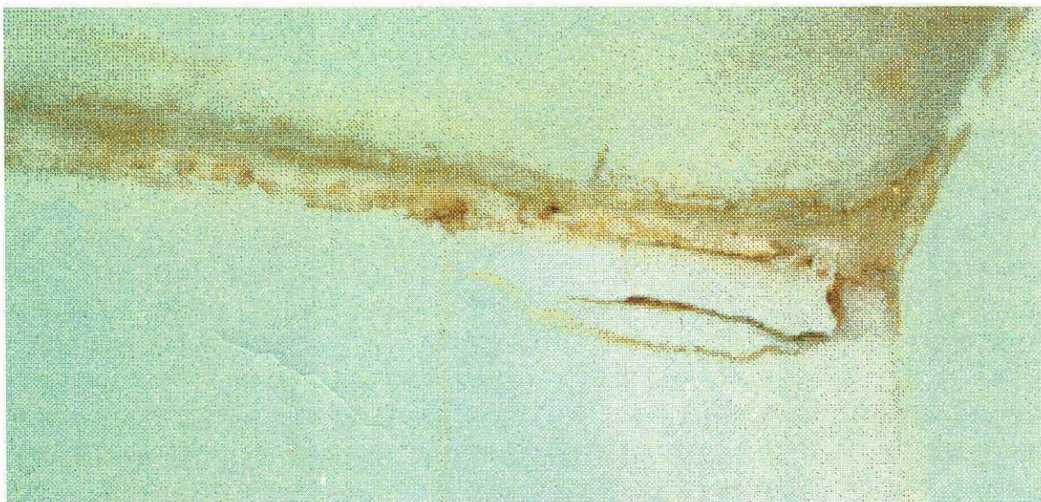
FIGURA 2.08 – Ilustração da desintegração de alvenaria causada pelo confinamento de depósitos de sais devido à aplicação de revestimentos cerâmicos vítreos.
