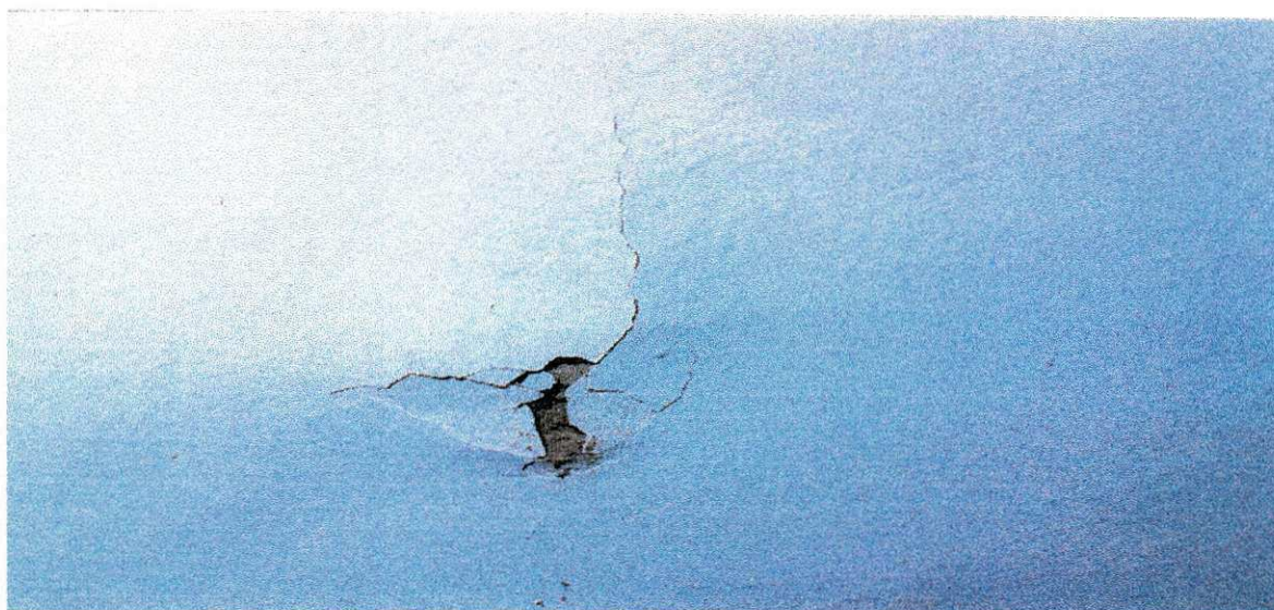
FIGURA 2.03 – Ilustração da perda de massa de alvenaria ocasionada pela formação de depósitos de sais.
