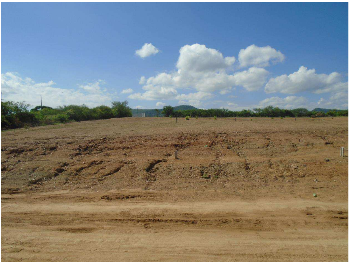
Figura 9 - Indícios do surgimento de processos erosivos provocados pela retirada da vegetação.
