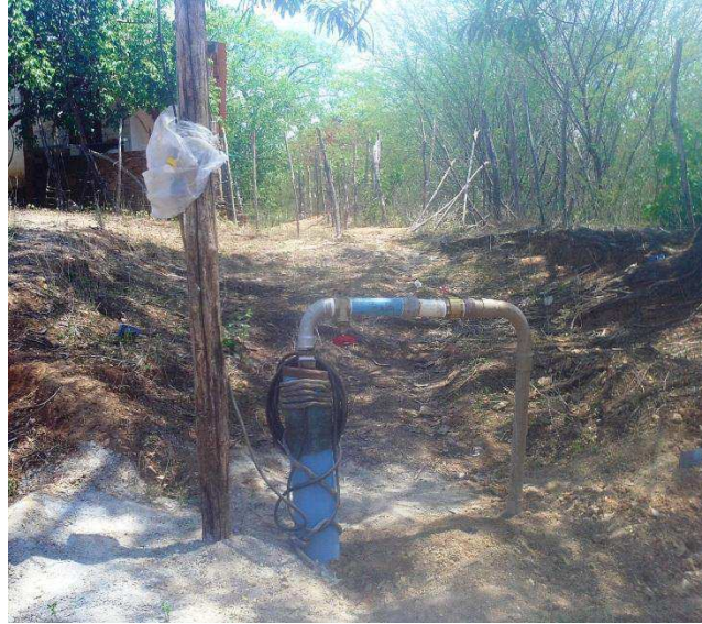
Foto 05: Poço Artesiano atual usado para o Abastecimento Comunitário. Foto do autor, Jan 2015.
