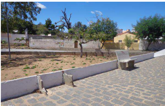
Foto 29- Praça Cristiano Cartaxo. Precário estado de conservação do mobiliário urbano, agosto de 2014 (foto da Autora).
