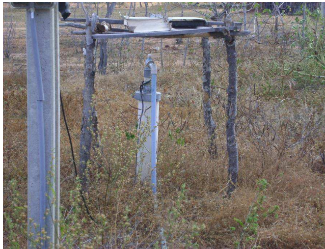
Figura 8: Poço tubular saída da bomba
