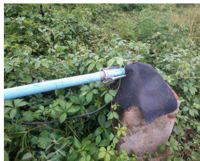
Figura 11: saída da bomba sem cobertura
