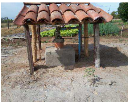
Figura 10: saída da bomba protegida com cobertura
