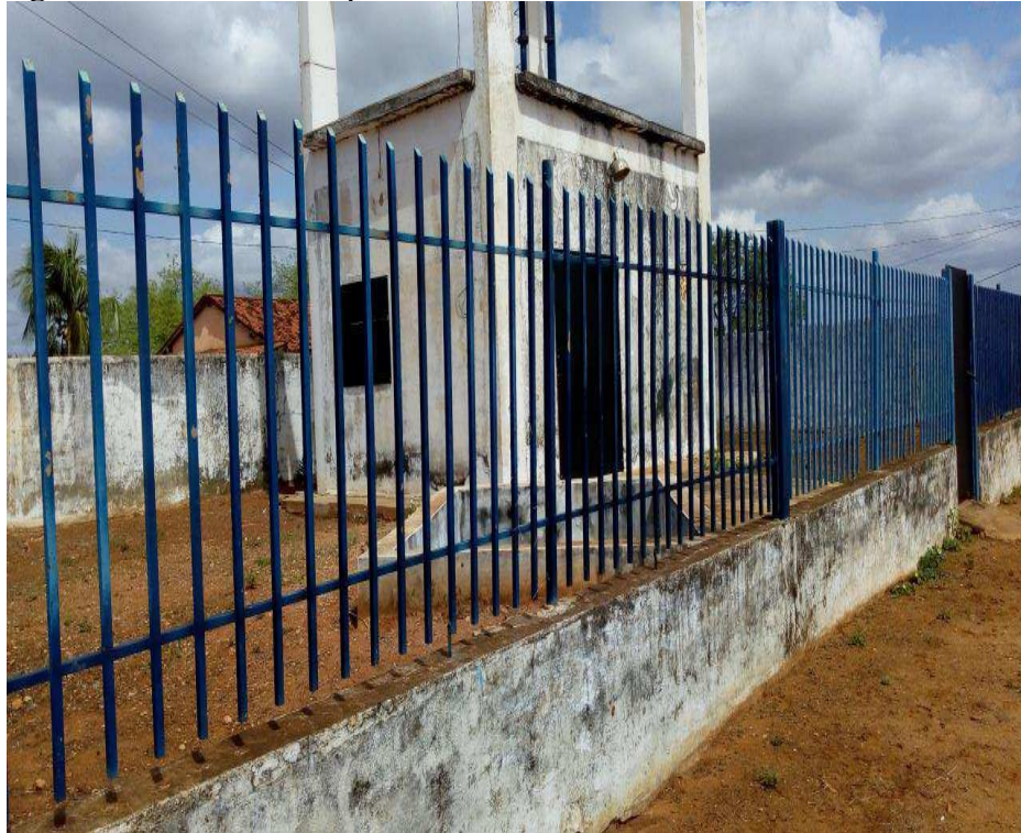
Figura 4 -Abandono do prédio da CAGEPA
