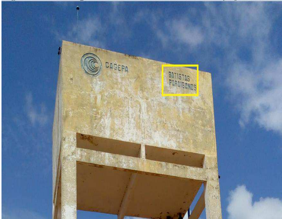
Figura 5 -Caixa d'água da CAGEPA levando o nome do projeto
