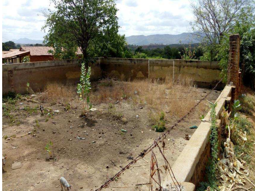
Figura 14 -Caixa do projeto que ficou desativada com o fim do bombeamento de água
