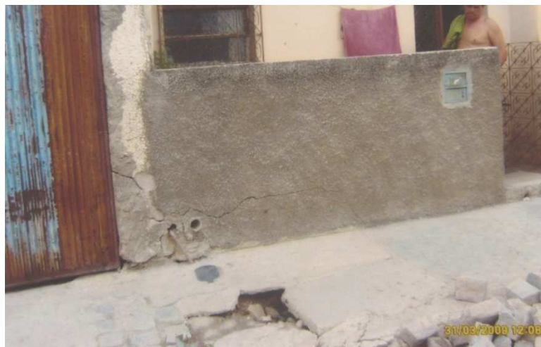
Figura 13-Fotografia de residencia apresentando rachaduras
