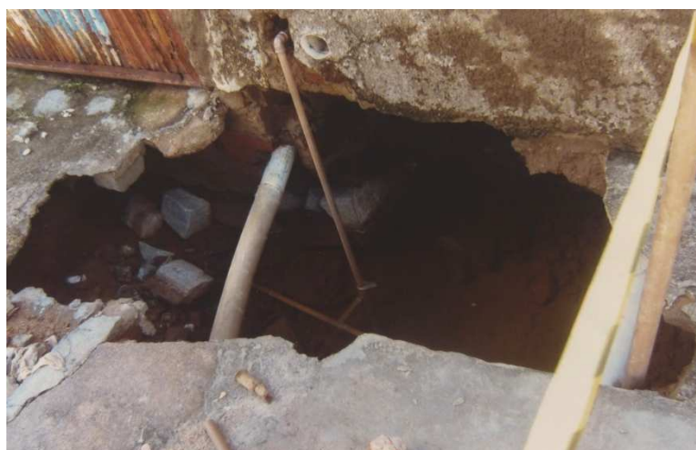
Figura 14- Fotografia indicando infiltração em residência.
