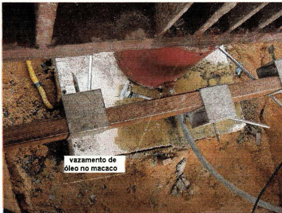
Figura 3.24– Vazamento de óleo no macaco, ocorrido na estaca E107 durante a prova de carga do Edifício Aderbal Jurema.
