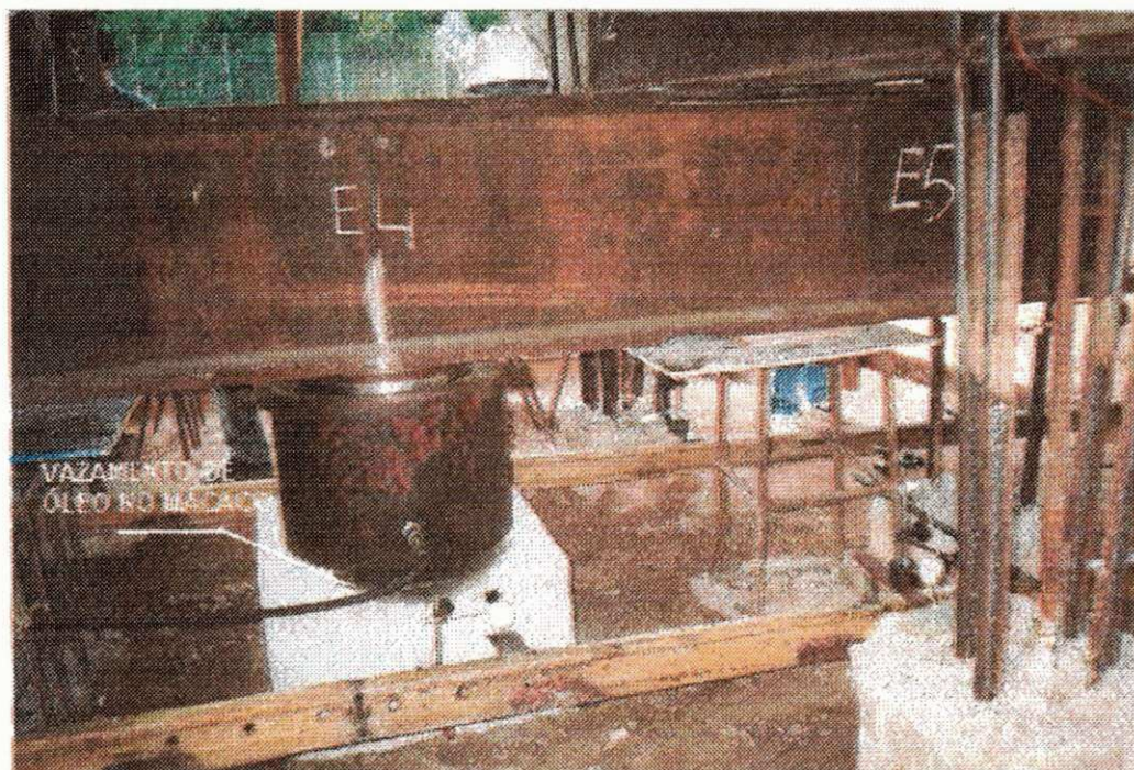
Figura 3.25– Vazamento de óleo no macaco hidráulico utilizado nas provas de carga sobre a estaca E04 do Edifício Parque dos Manguezais.
