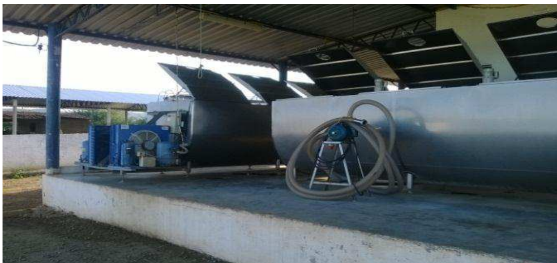
Foto 19: Tanque industrial para armazenamento do leite. Fazenda Sanhauá.
