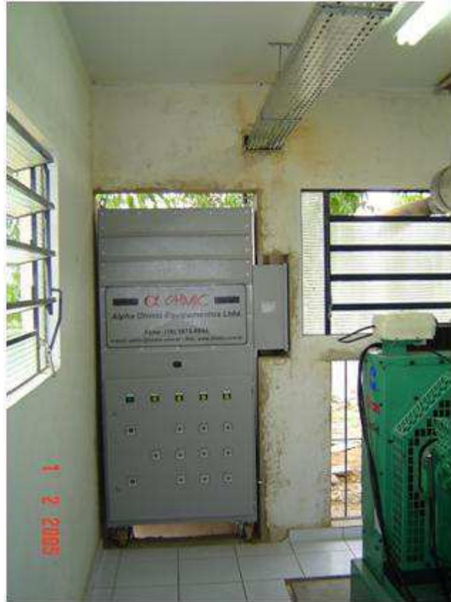
Figura 3.18 - Banco de carga de 150 kW
