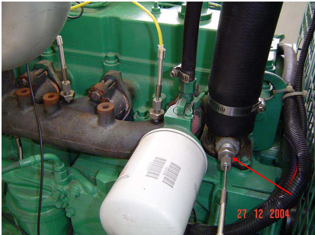
Figura 3.11 - Termopar instalado para medição da temperatura da água na saída do motor.
