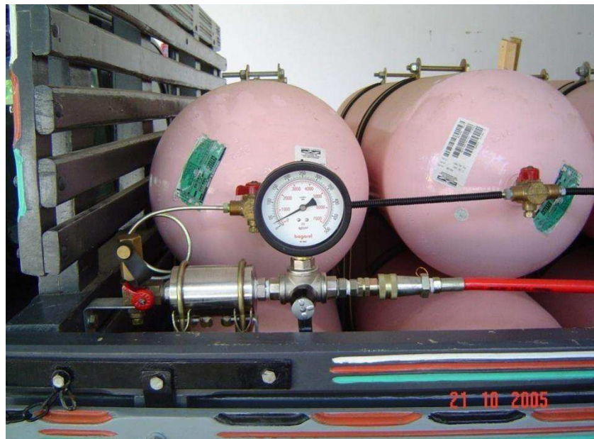
Figura 3.19 - Sistema de armazenagem de gás.
