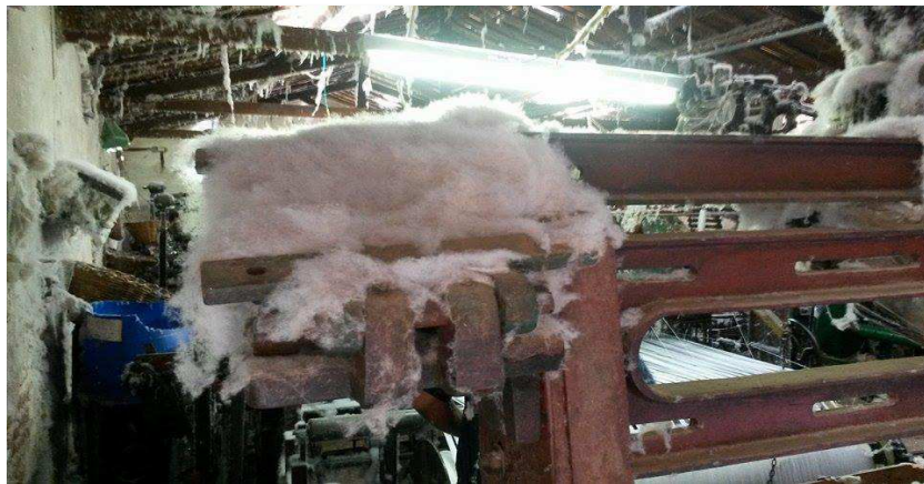
Foto 7: Acúmulo de “pelo” nas máquinas e no telhado da fábrica. Fonte: Acervo do autor (2015)
