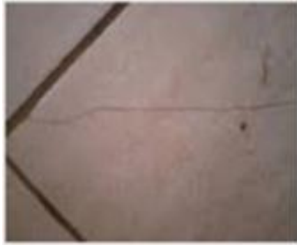
Figura 2.3 – Foto de produto com fissura.
