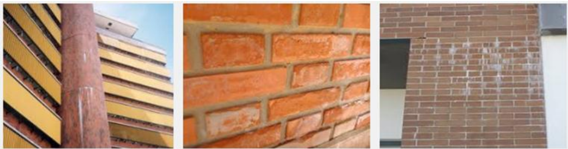
Figura 2.7 – Foto de produtos com eflorescência.
