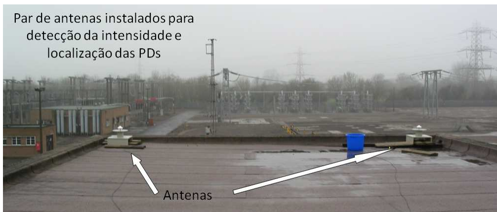
Figura 3.13: Sistema de detecção radiométrico implementado na subestação de Melksham.
