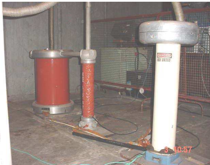
Figura 3.4 - Fotografia do arranjo experimental de detecção de descargas parciais.
