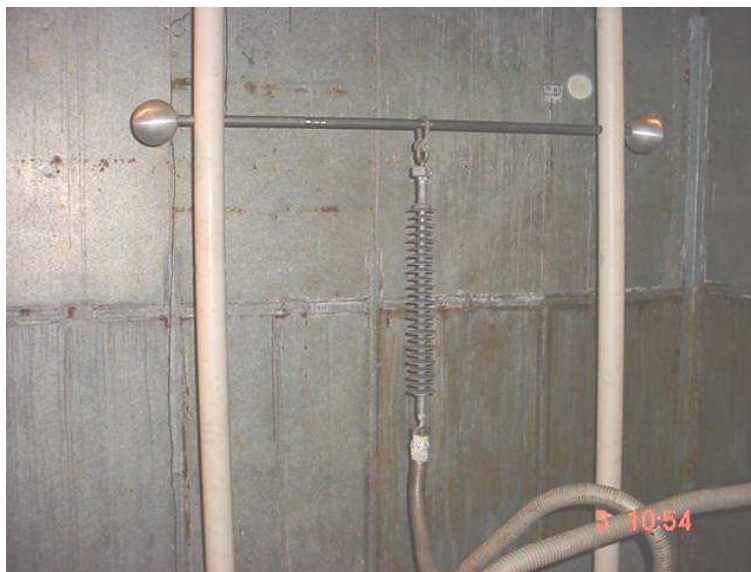
Figura 3.5 - Isolador Polimérico e suporte utilizado.
