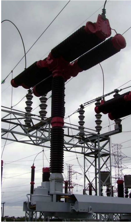
Disjuntor 14T6 Siemens 3AS3
