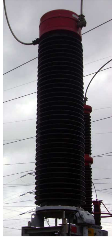
Transformador de Corrente 94T6 Balteau SEX220
