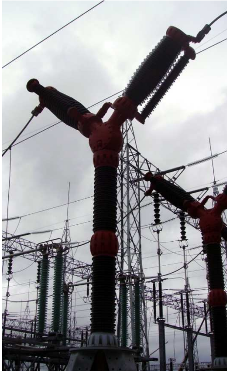
Disjuntor 14V4 Inebrasa FA2
