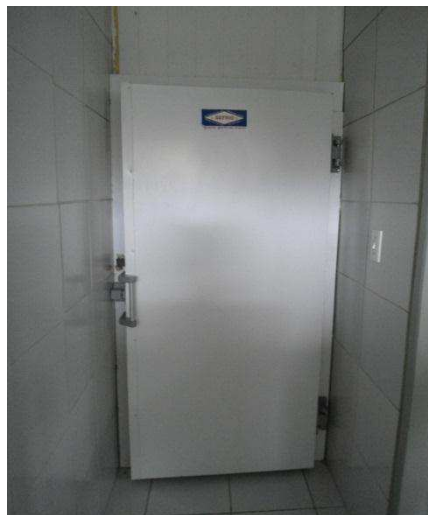
Figura 12 – Porta de acesso às câmaras frias do Restaurante Universitário/CES
