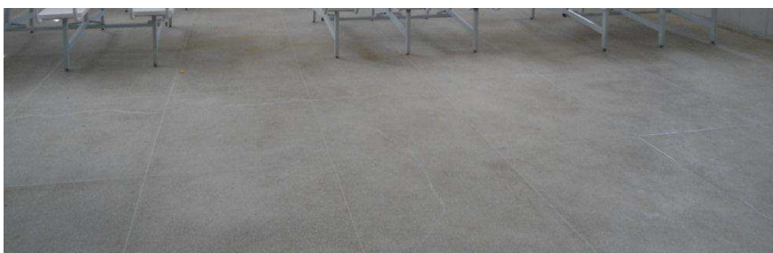
Figura 9 – Piso do refeitório do Restaurante Universitário/CES
