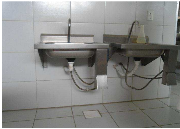
Figura 15 – Ralo e conjunto de sifões do lavatório de mãos dos funcionários do Restaurante Universitário/CES
