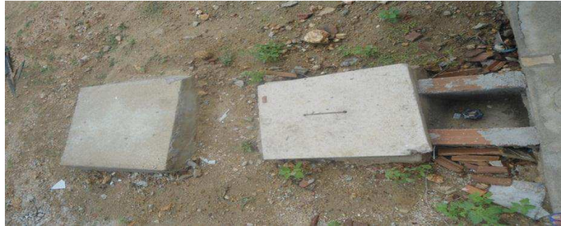
Figura 17 – Caixa de Gordura do Restaurante Universitário/CES
