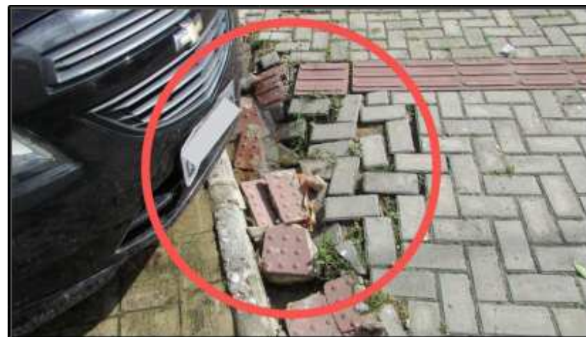
Ilustração 31–Registro fotográfico (d) de calçada com obstrução por veículo e com presença de problemas estruturais avançados
