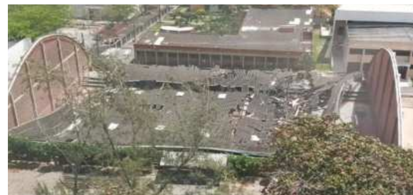
Ilustração 2–Desabamento de teto do Ginásio Poliesportivo da UFCG–CG em 2021
