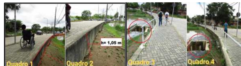
Ilustração 39–Área potencialmente perigosa não atende à NBR 9050 (2021)
