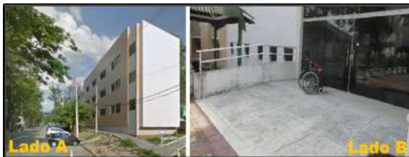
Ilustração 42–Panorâmica do Bloco BG e rampa de acesso sem acessibilidade no Bloco
