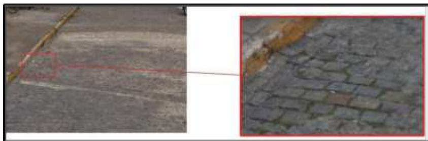
Ilustração 37–Calçamento irregular com trepidação danosa ao uso de cadeira de rodas
