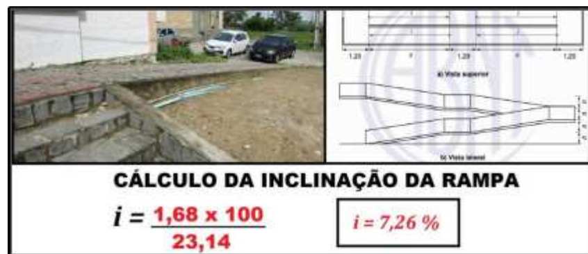
Ilustração 30–Comparação da Norma com a rampa de acesso ao Bloco BG (lado oeste)
