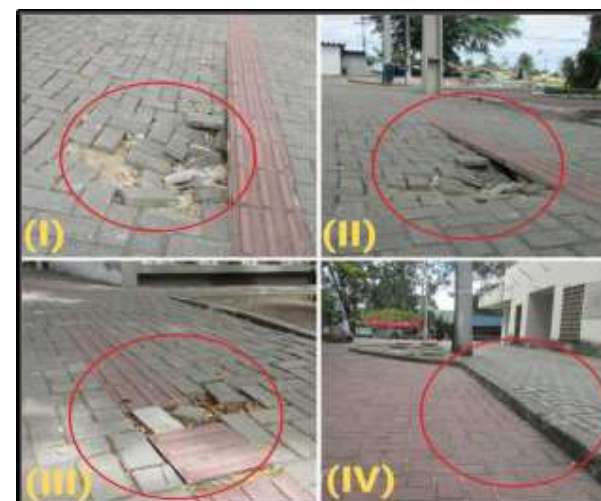
Ilustração 34–Pontos danosos e/ou fora da Norma
